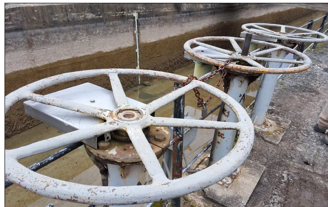
Figura 5. Compuerta actual de la toma lateral Iv-0,010
