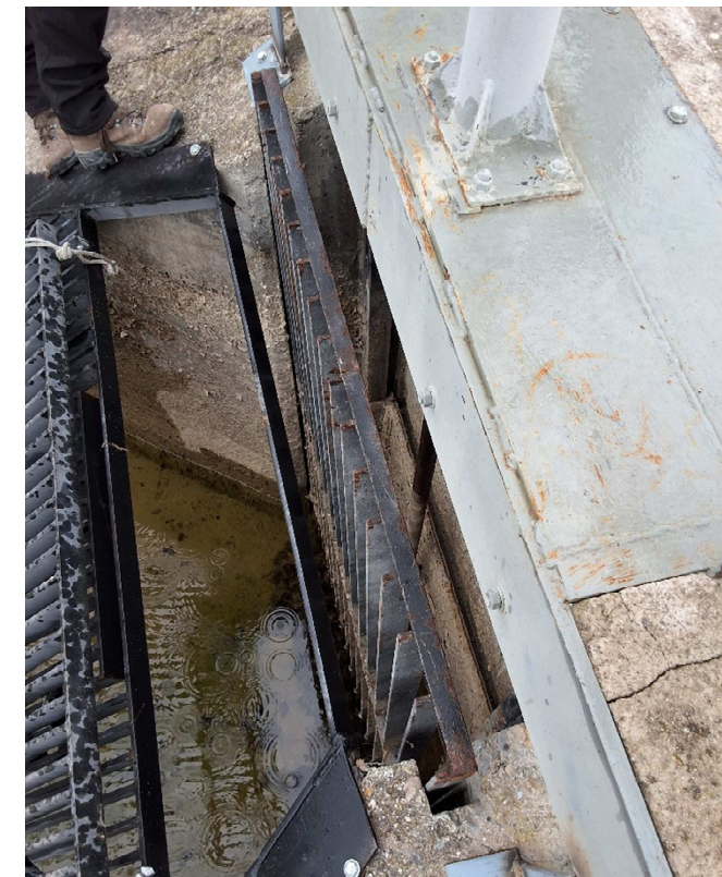
Fotografía 27 Compuerta S-9,520 en la Acequia de Selgua. Reja de desbaste.
