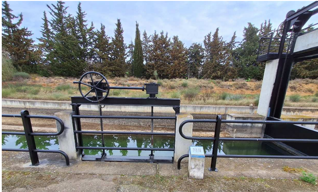
Fotografía 20 Compuerta P-9,880 en la Acequia de Pertusa.
