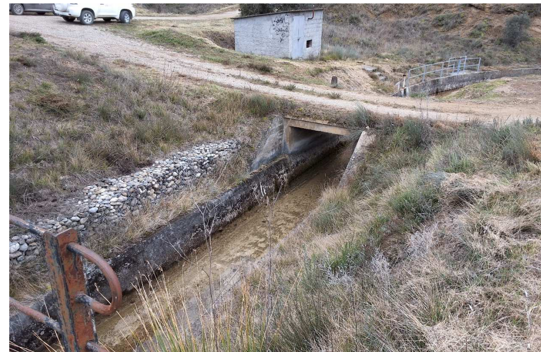
Fotografía 7 Compuerta Iv-0,010 en la Acequia izquierda del Vero.
