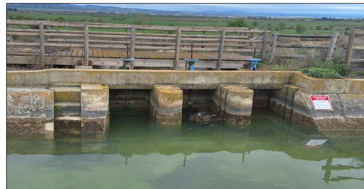
Figura 9. Compuerta actual de la toma lateral V-13,584
