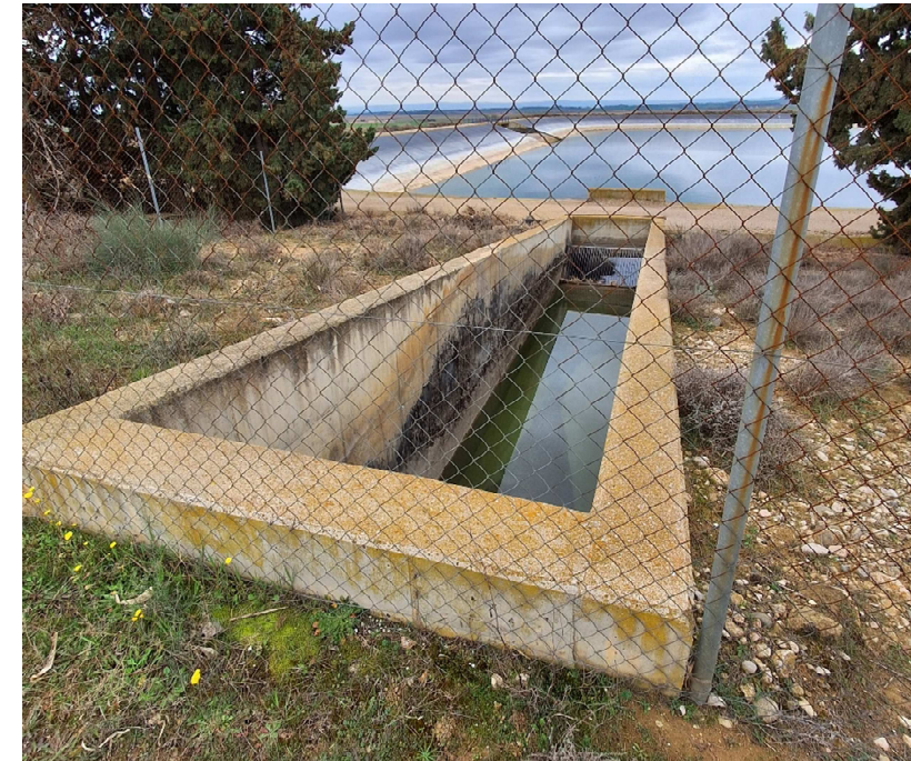
Fotografía 22 Compuerta P-9,880 en la Acequia de Pertusa.
