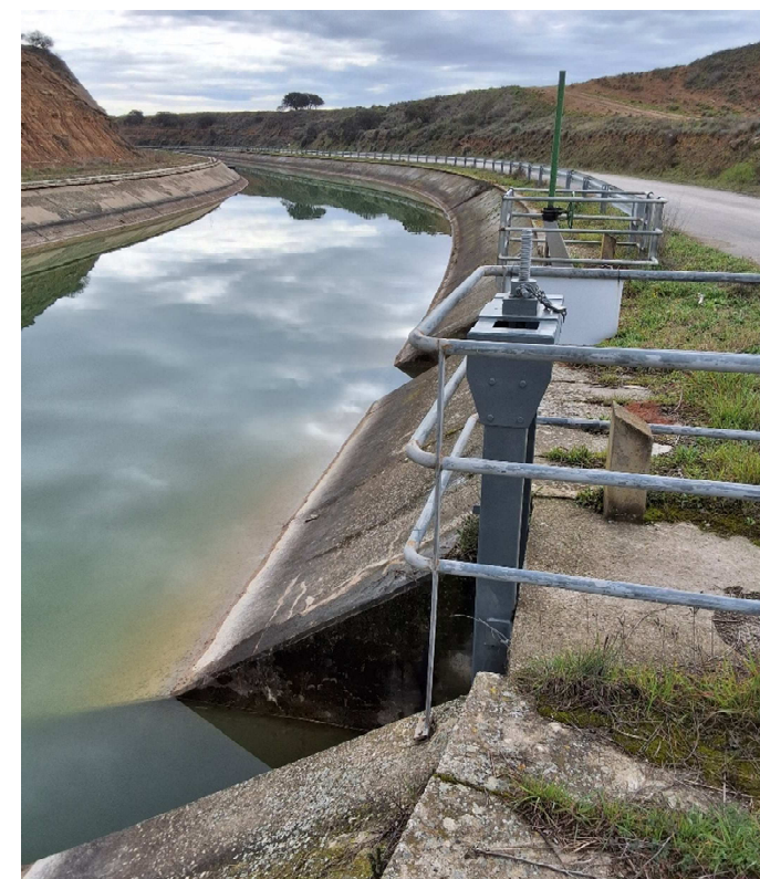
Fotografía 3 Compuerta C-74,060 en el Canal del Cinca.
