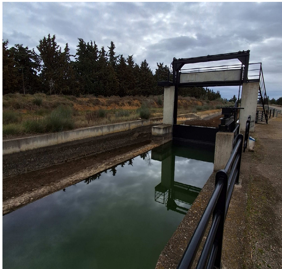
Fotografía 21 Compuerta P-9,880 en la Acequia de Pertusa.
