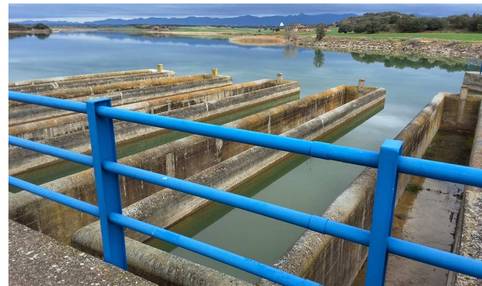
Fotografía 1 Compuerta C-74,060 en el Canal del Cinca. Aliviadero en Embalse de Valdabrá.
