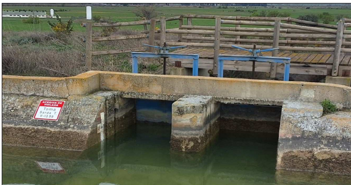
Figura 10. Compuerta actual de la toma lateral V-13,593
