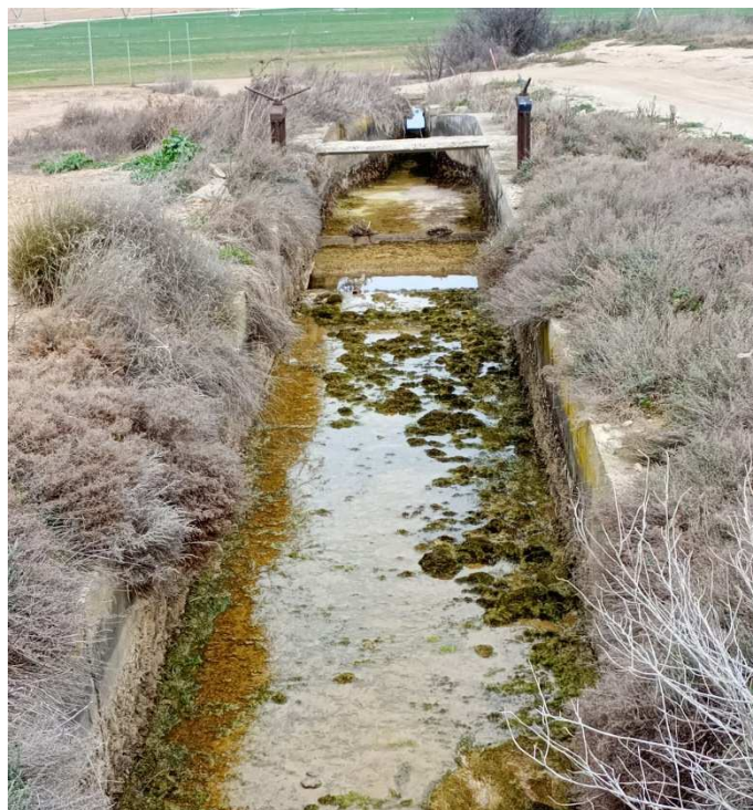
Fotografía 17 Compuerta M-60,085 en el Canal de Monegros. Canal abierto hacia CR Orillena.
