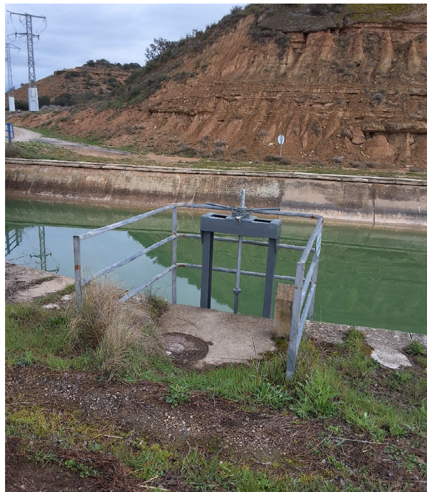
Fotografía 2 Compuerta C-74,060 en el Canal del Cinca.
