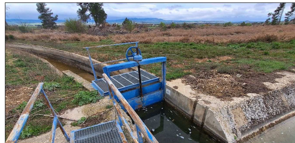
Figura 10. Compuerta actual de la toma lateral V-13,593
