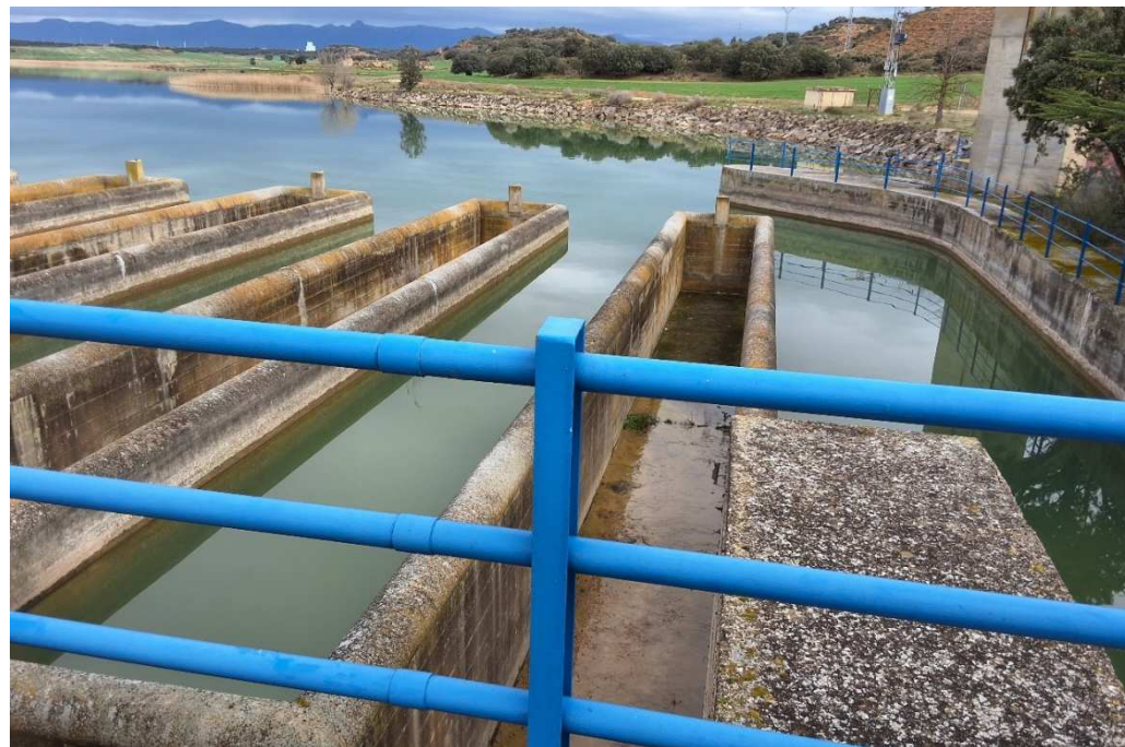
Fotografía 4 Compuerta C-74,060 en el Canal del Cinca. Aliviadero en Embalse de Valdabrá.
